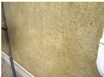
高圧洗浄前の外壁塗装面。
