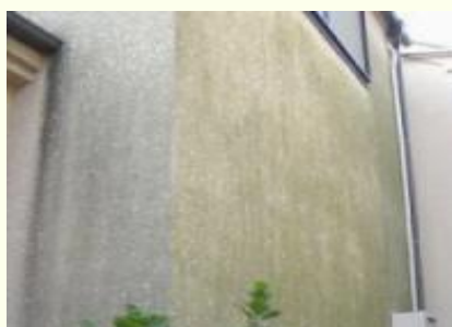
外壁リシン面に青カビが発生
