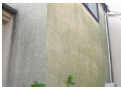
外壁リシン面に青カビが発生
